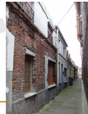
Quartiers anciens dégradés
